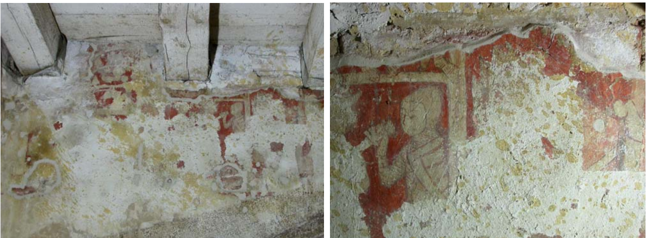
Langhaus/ Nordwand, westliches Joch, Wandbereich unterhalb der eingezogenen Zwischendecke. Links: Zustand nach der konservatorischen Notsicherungsmaßnahmen zur Sicherung des Malereifragmentes. Rechts: Detailaufnahme. Zu sehen ist eine Randanböschung mit Kalkmörtel und eine Freilegungsprobe im Malereibereich. Durch die exemplarische Freilegung konnte festgestellt werden, dass der Malereibestand in diesem Bereich einen sehr gut erhaltenen Zustand aufweist und die künstlerische Qualität des Heilsspiegelzyklus sehr gut ablesbar ist.
